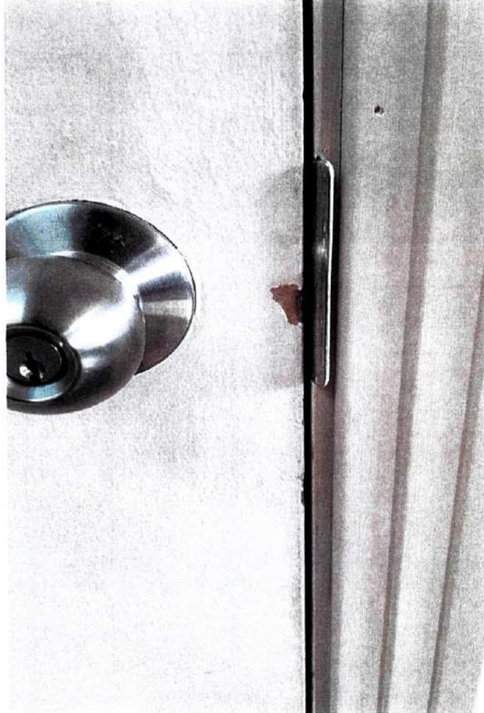
Trace d'effraction sur la porte du dépôt des dossiers dans les Archives. La porte était fermée et barrée, la clé permettant de l'ouvrir était dans le seul tiroir ouvert de la table de consultation qui se trouve immédiatement sur la droite.
